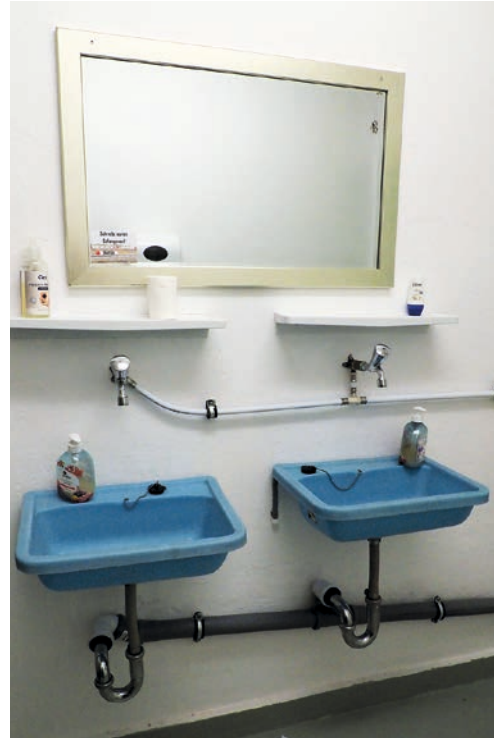
Beachtlich ist, dass selbst die Sanitärausstattung aus Kunststoff – die Fremd- und Selbstgefährdung verhindern sollte – ins Nutzungskonzept einbezogen worden ist
